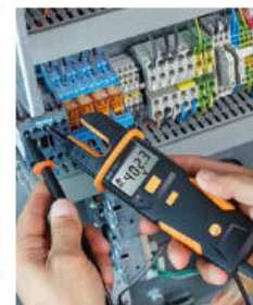
Strommessung an einer Kälte-Außeneinheit mit testo 755 .
