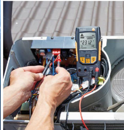
Spannungsmessung an einer Kälte-Außeneinheit mit testo 760 .
