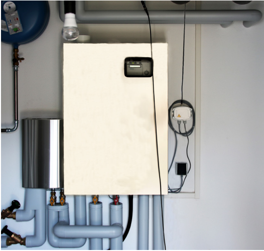
M-Bus-Mastergateway im Untergeschoss
